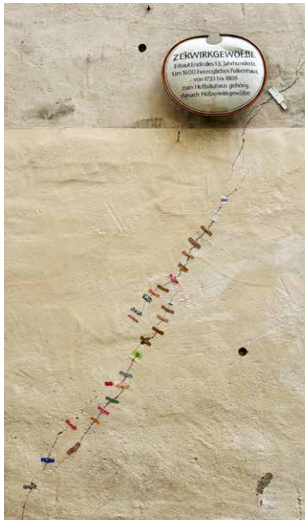
Historisches Gebäude, von Heftpflaster zusammengehalten
